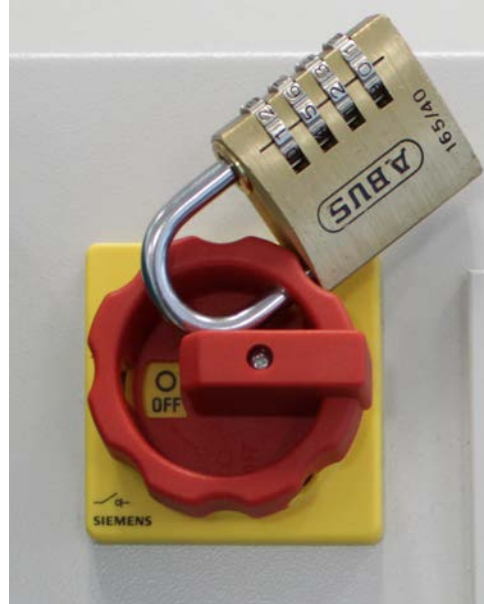
Abb. 2: Mit Schloss gesicherter Elektro-Hauptschalter
