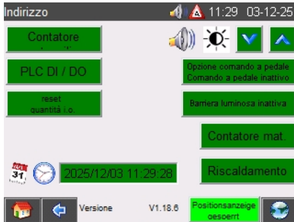
Fig. 36: Barriera luminosa inattiva
