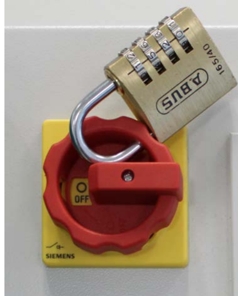
Abb. 2: Mit Schloss gesicherter Elektro-Hauptschalter
