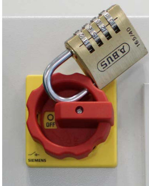
Fig. 2: Interrupteur électrique général bloqué par un cadenas
