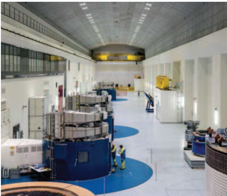
Jede der vier Pumperturbinen in der Maschinenkaverne hat eine Leistung von 250 MW. Bild: Axpo Power AG
